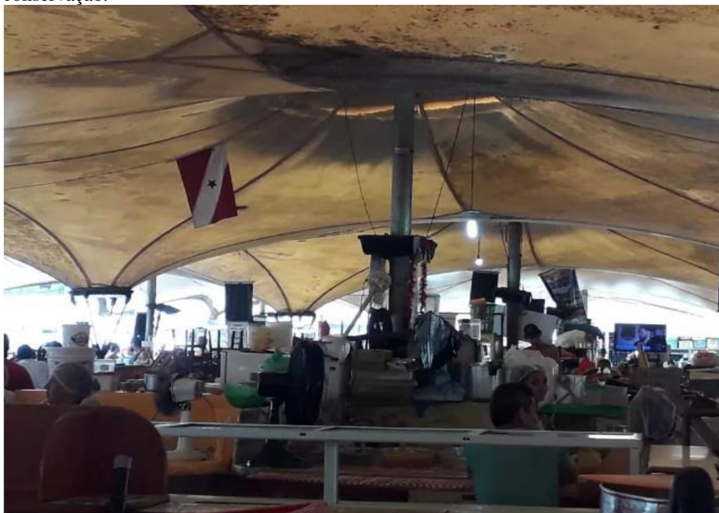
Figura 5 - Lona de cobertura das barracas do setor de alimentação do Ver-o-Peso em má condição de conservação.
